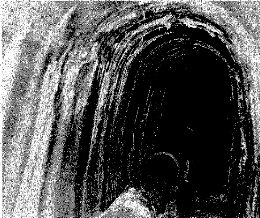
Fig. 7. Dépôts de carbonate de calcium recouvrant le revêtement en béton d'une galerie percolée par des eaux d'infiltration.
