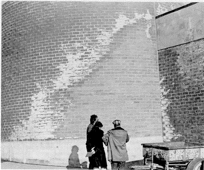
Fig. 9. Dépôts de sulfate de sodium sur le revêtement en briques de terre cuite, traitées au silicone, d'un digesteur en béton d'une station d'épuration des eaux.
