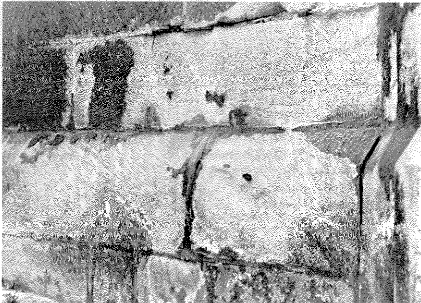
Fig. 8. Eglise St-François à Lausanne, façade nord. Subflorescences de chlorure de sodium et de sulfate de calcium responsables de l'éclatement de la croûte de salissures et de la décohésion (sablage) de la molasse.
