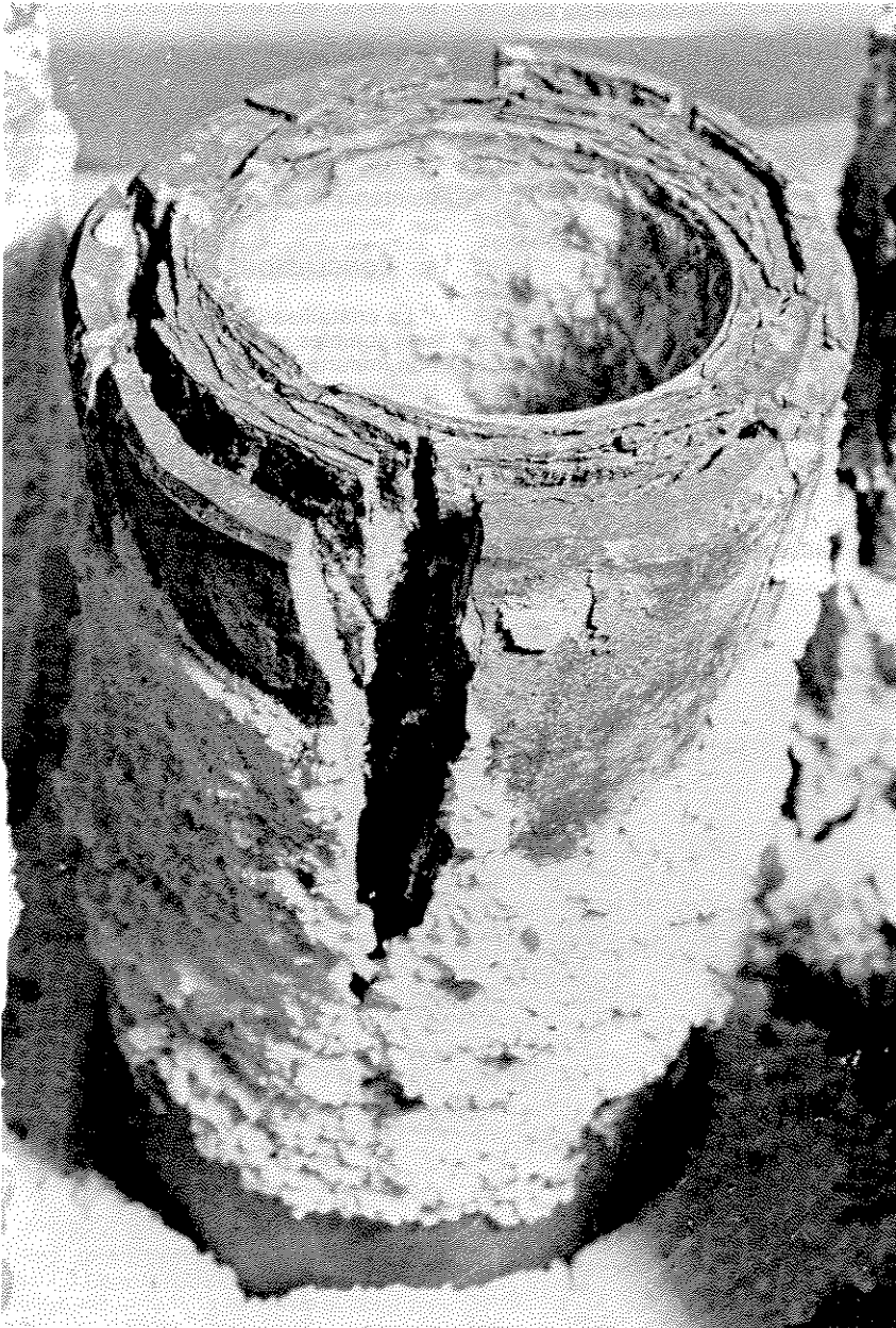
Fig. 12. Tuyau de drainage en terre cuite soumis à la remontée capillaire d'une solution de sulfate de sodium.
